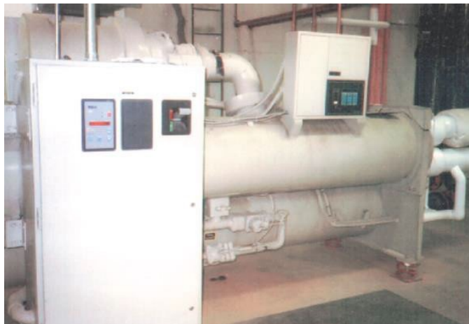
Figure 3 – Un refroidisseur du type centrifuge (Ressources naturelles Canada, 2018)
